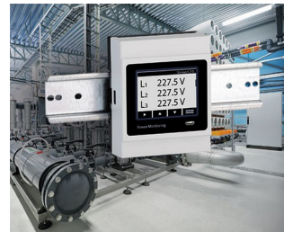
Monitoring elektrischer Größen
