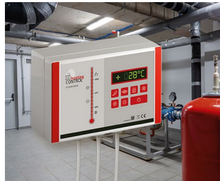
Contrôle du chauffage
